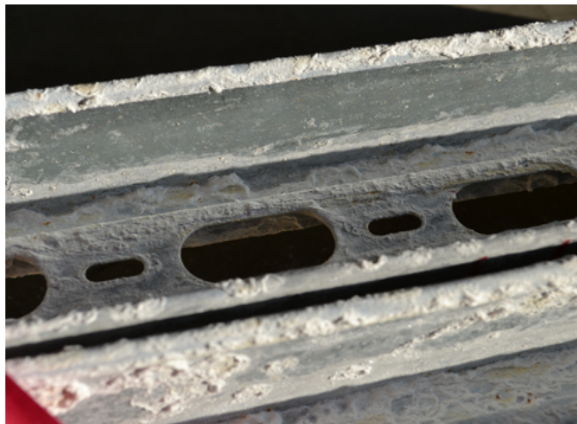
XPG pinnoitettu MEK-valaisinkisko suolasumutestin jälkeen.
